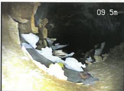
【内面防食塗装劣化(シールートの剥離)】
