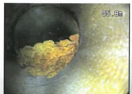
【接合部の錆瘤成長による閉塞】
