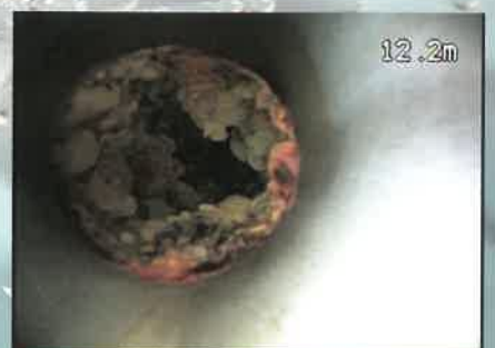
【無ライニングの異形管部に錆瘤による閉塞】
